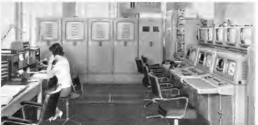
Bild 11. Schalt-, Verteil- und Kontrolleinrichtungen in der Fernseh-Schaltstelle der Deutschen Bundespost in Frankfurt am Main (Fernmeldehochhaus)
